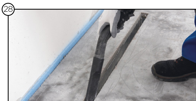
Reinigen des Ausblaskastens
