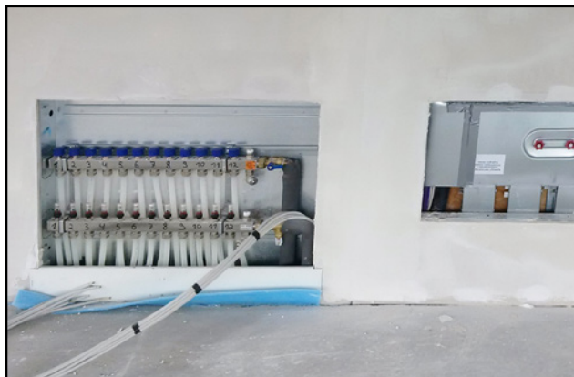
Heizkreisverteiler und Luftverteiler
